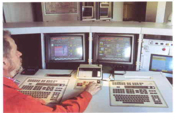
Förderbetrieb und Aufbereitung werden über Kontrollanlagen und Computer von Fachleuten gesteuert und ständig überwacht.
