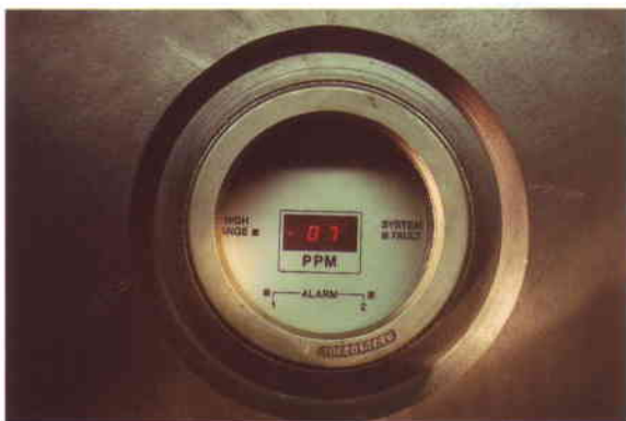
Die Wasseraufbereitung wird ständig kontrolliert. Sollte dieser sogenannte Ölmonitor eine Verunreinigung des Wassers von \geq 10 ppm Öl - zehn Teile von einer Million Teilen - anzeigen, stoppt eine Schnellschlußanlage die Einleitung ins Meer.
